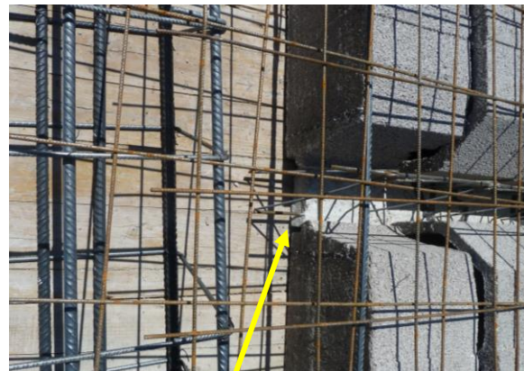
Fig.5. Deficiente longitud de vigueta, sin conexión a la viga
