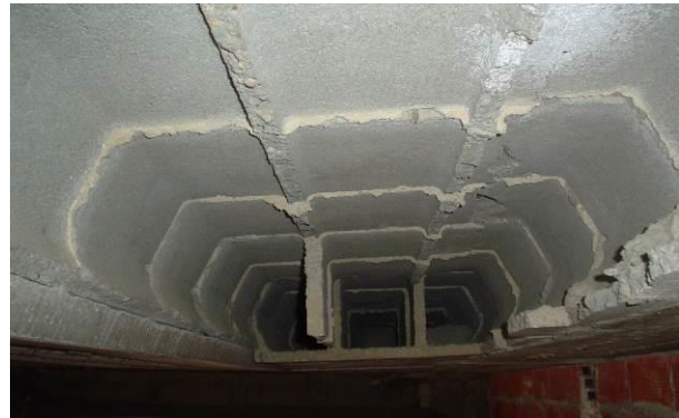
Figura 14. Rotura y desprendimiento de bovedillas de hormigón por deformaciones diferenciales
