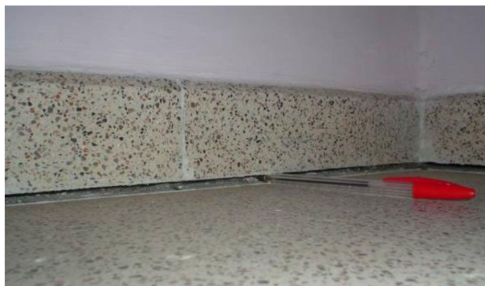
Figura 10. Separación tabique-solado por deformaciones diferenciales o excesivas de forjado
