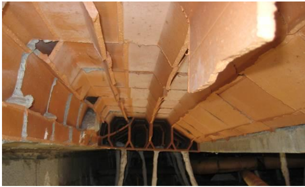
Figura 13. Rotura y desprendimiento de bovedillas cerámica por expansión de humedad
