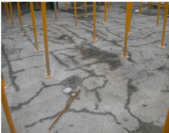
Figura 15. Fisuración por retracción hidráulica
