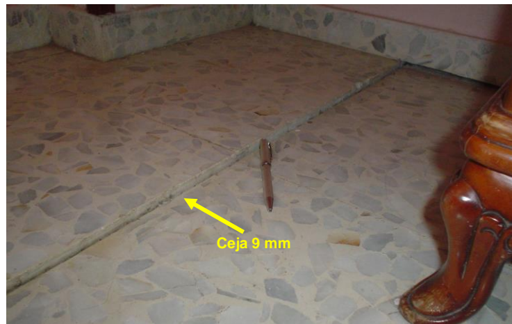
Figura 11. Lesiones en solado por deformaciones diferenciales o excesivas de forjados
