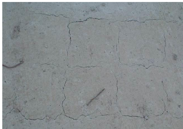
Figura 16. Fisuración por asiento plástico
