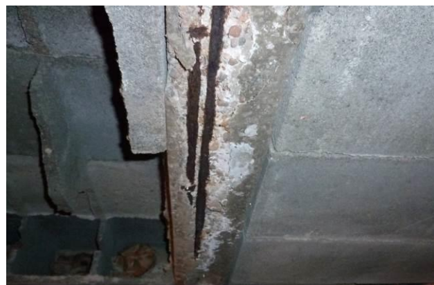
Figura 17. Desprendimiento del hormigón de vigueta por corrosión de armaduras
