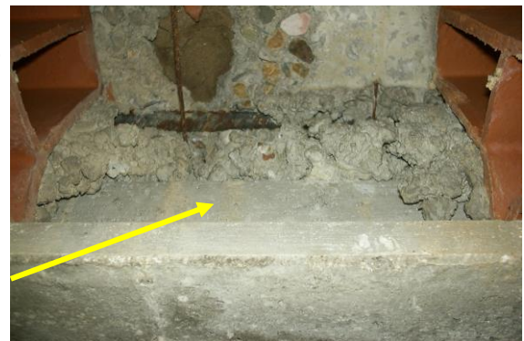
Figura 8. Deficiente vertido y compactado del hormigón entre vigueta y bovedilla
