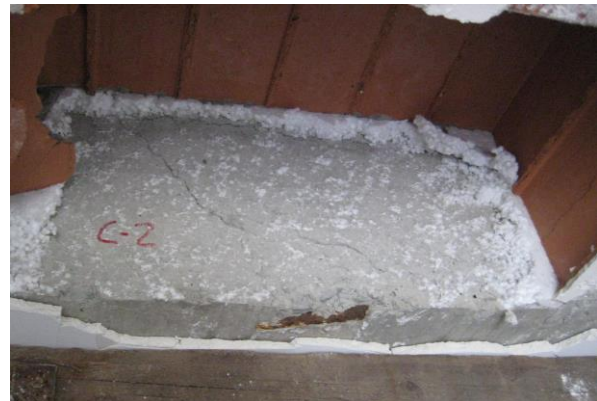
Figura 19. Fisuración en viga por esfuerzo cortante
