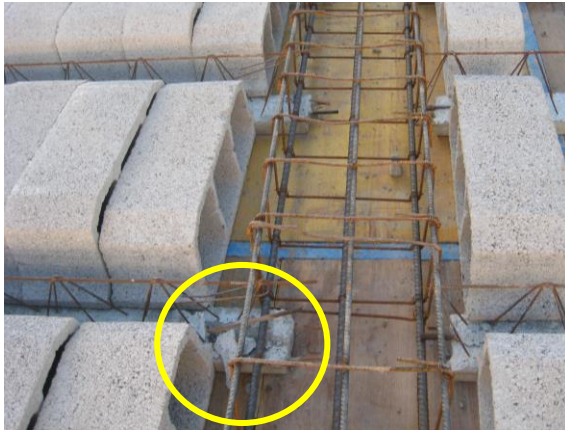
Figura 6. Montaje de viguetas bajo el armado inferior de la viga. INCORRECTO
